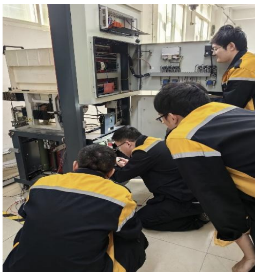
直流开关柜检修实训
